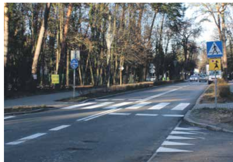
Droga powiatowa nr 1502W – ul. Jana Pawła II w Podkowie Leśnej po remoncie.
